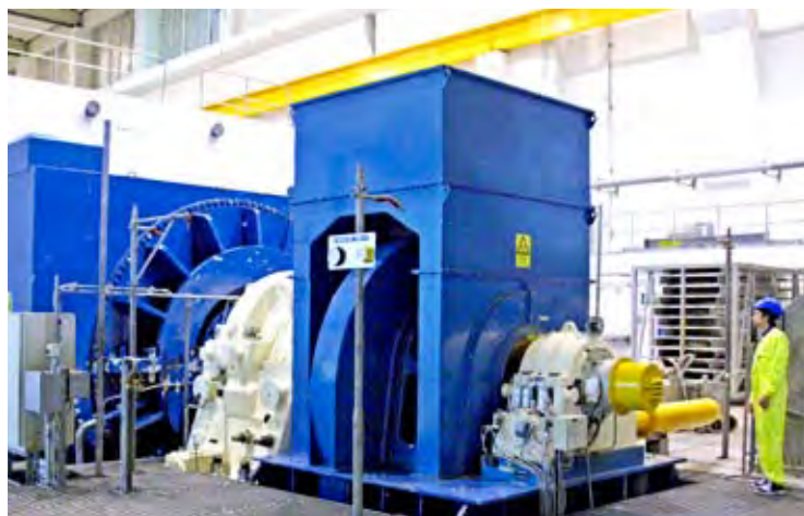
Forsmark 3 har en generator. Den omvandlar turbinens rörelseenergi till elektrisk energi. Generatoren är direkt kopplad till turbinaxeln och roterar 1 500 varv per minut.
