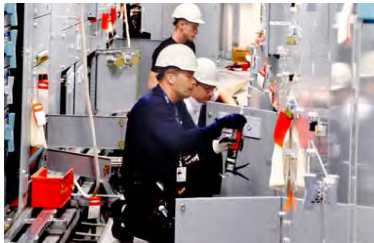
Efter kränktsolyckan i Fukushima jordbävningssäkrades Forsmarks dieselstallverk. De förser reaktorerna med reservkraft i händelse av elbortfall.
